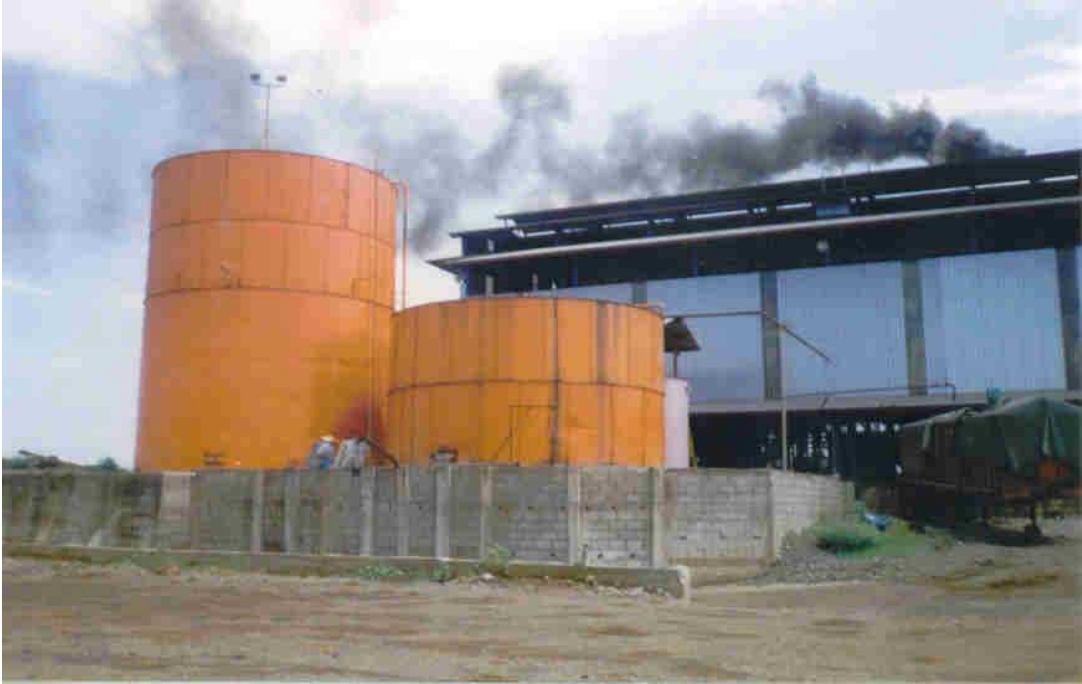
Figura No. 7: Fotografía de los Tanques de Deposito de Aceite Extractora “El Horizonte”, Coatepeque.
