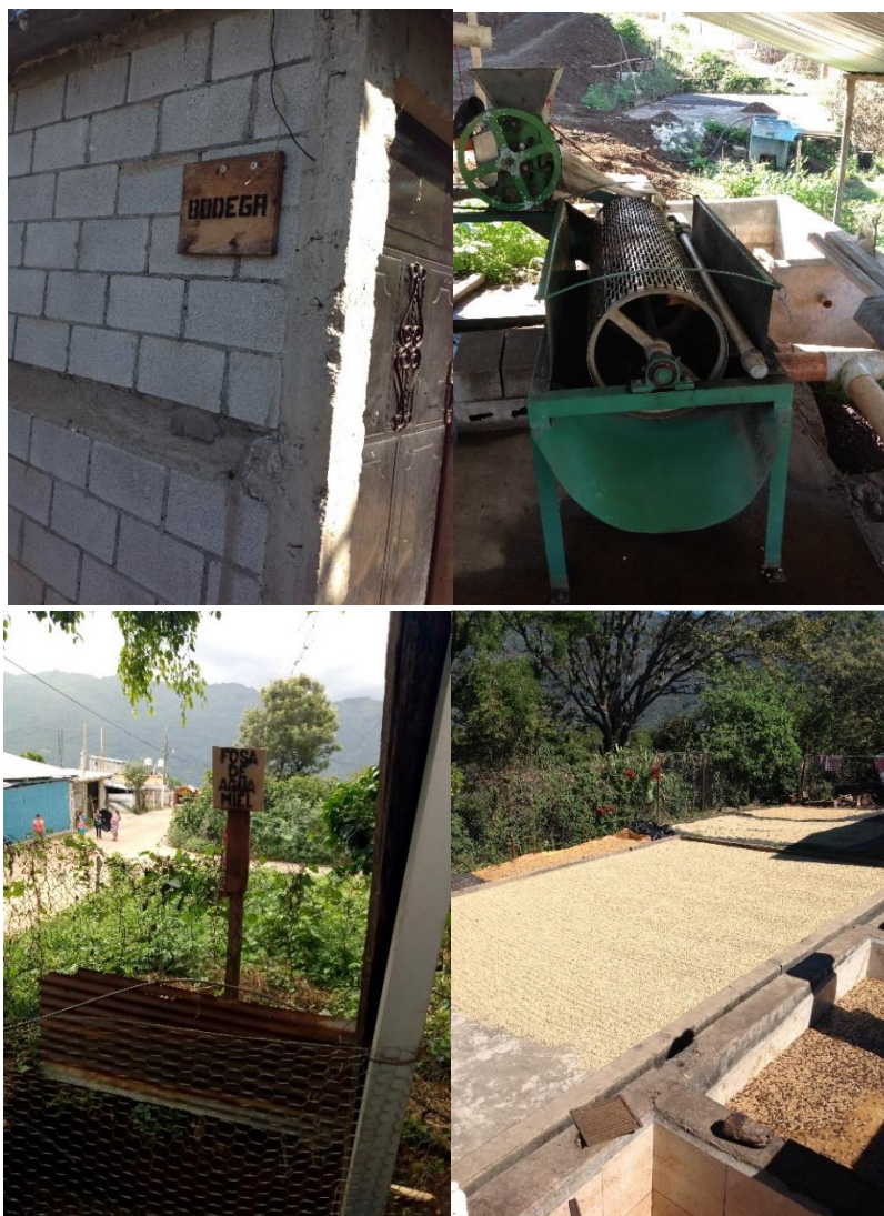
Figura 30. Inspección de infraestructura por requisito de inspecciones internas previo a auditoria en cumplimiento a criterios básicos de la norma -RAS-.
