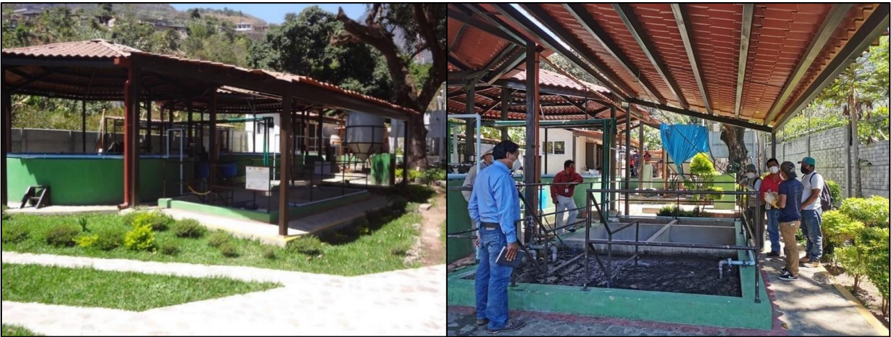
Figura 2. planta de tratamiento de aguas residuales.
