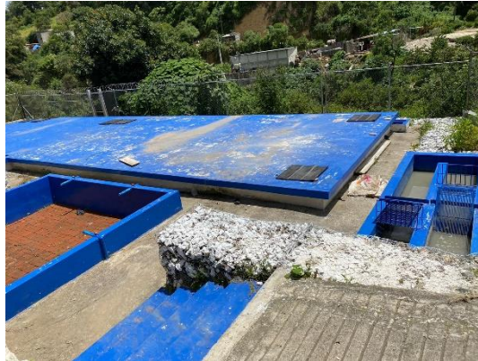
Figura 26. Planta de tratamiento de aguas residuales, donde se llevó a cabo la caracterización.
