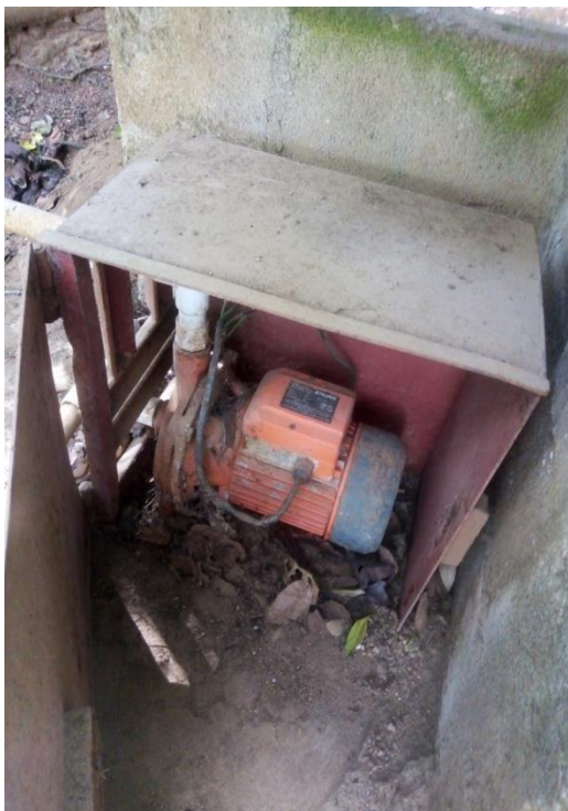
Figura 72A: Bomba de agua.
